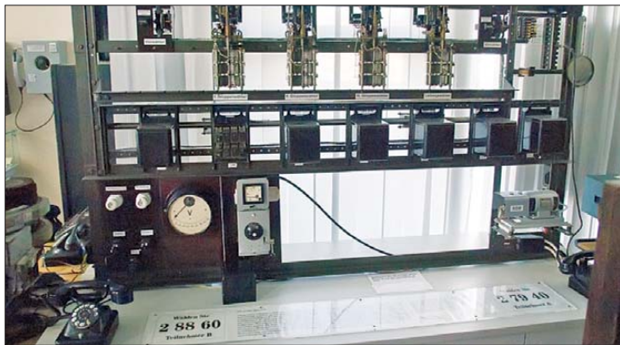
Alt, aber lange in Betrieb gehalten: Vermittlungsanlage des Systems 22
